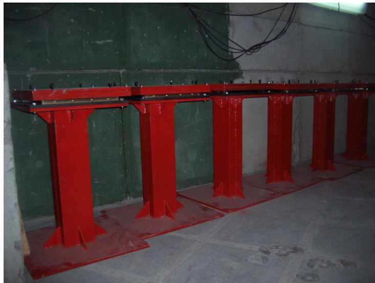
Рис. 7. Стойки и юстировочные опоры головной части нейтроновода 7 канала.
