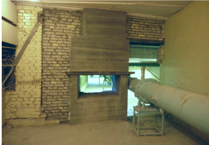
Рис. 6. Реконструкция несущей колонны здания 117 для проводки изогнутых нейтронопроводов спектрометров Эпсилон и Скат.
